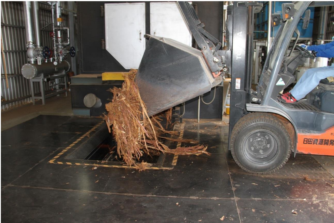
写真4 ボイラーに投入されるパーク
